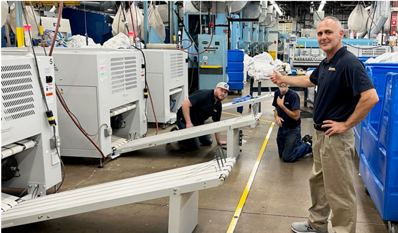
El gerente regional de Nueva Inglaterra, Ray Neal , supervisó la ubicación y la instalación. ¡Al día siguiente, las nuevas máquinas Foltex estaban sacando ropa!
